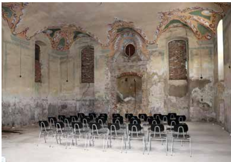
Im Innenraum haben die prächtigen Wand- und Deckenmalerien die wechselvolle Geschichte überstanden. Eine Sanierung wäre jetzt angebracht.
