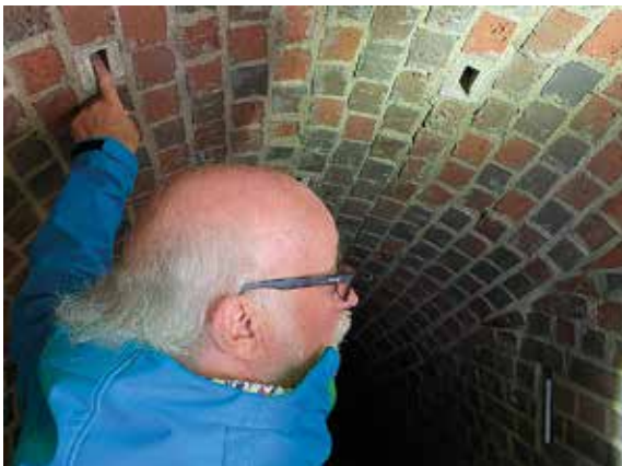
Stefan Schürmann weist auf die Spezialziegel hin, die den Fledermäusen als Schlaf- und Winterquartier dienen.
