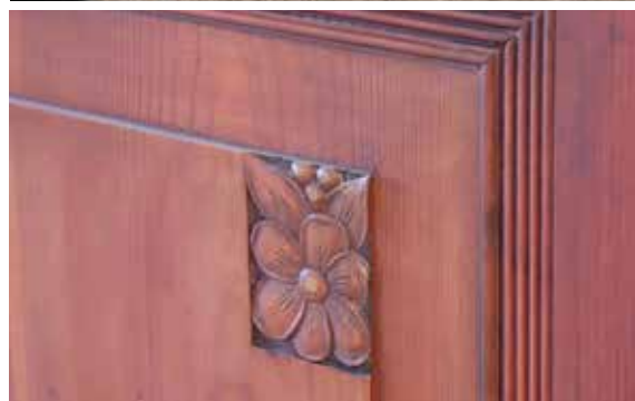
Das Alte Finanzamt ist ein typischer Vertreter des Historismus. Mit Liebe zum Detail wurden die Türen restauriert.
