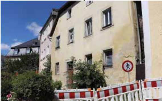
Akutfall - die Sanierung des Gebäudes steht an.
